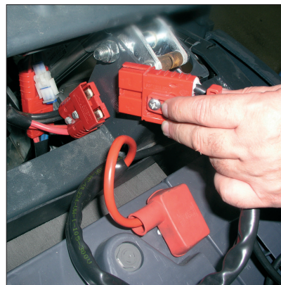
3. Überprüfen ob die Ladekabel in Ordnung sind.
