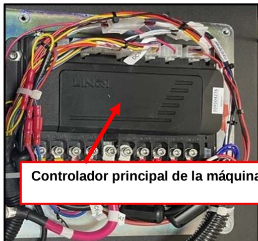
Controlador principal de la máquina (EB1)
