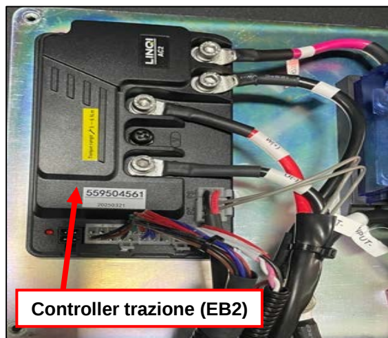
Controller trazione (EB2)
